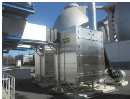
Neutralox Photoionisation auf der Kläranlage Emscher Mündung
